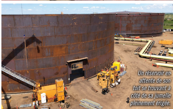
Une grue installée à l'intérieur d'un des réservoirs à moitié érigé illustre l'ampleur du chantier.
