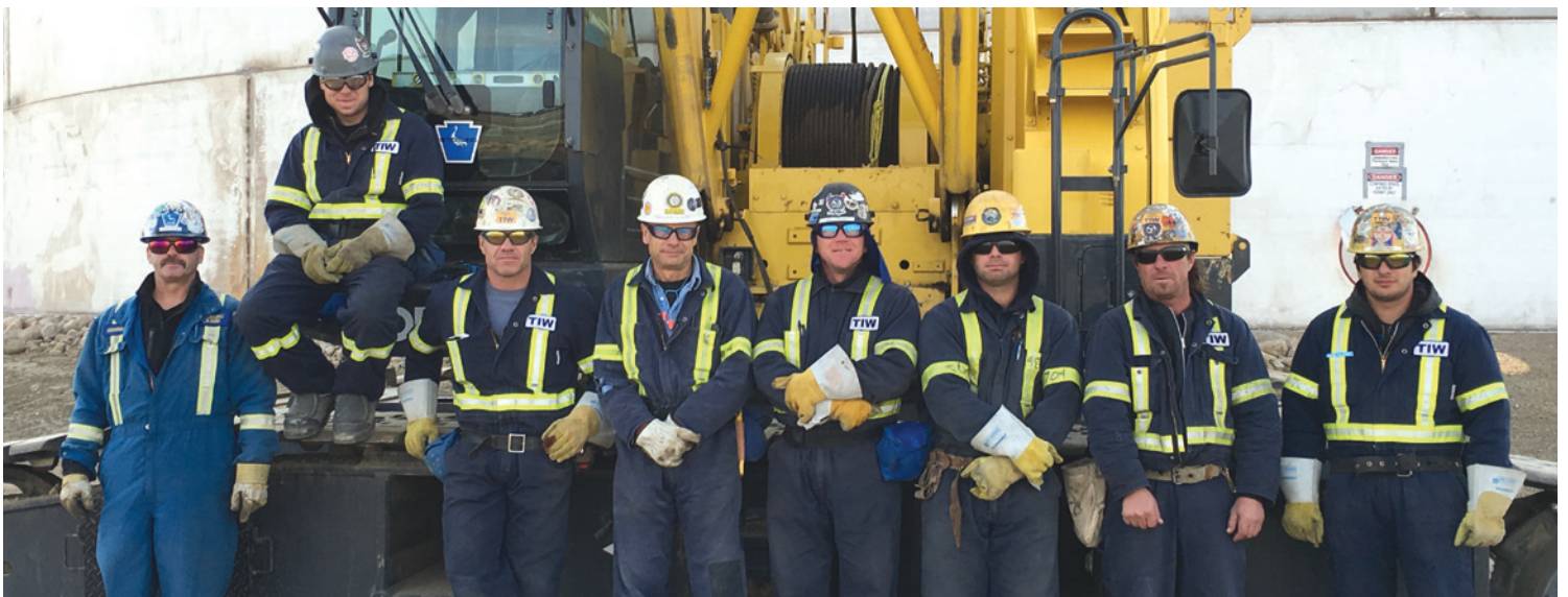
Un travail bien fait! L'équipe de la section locale 555 se fait prendre en photo après avoir terminé la construction du réservoir massif. L'équipe de Chaudronniers était formée des membres Clayton Rousseau, Jayden Aldrich, Jordan Izzard, Lyndon Mullis, Jamey Stringer, Chad Osask, Rory Bax et Des Mollison.
